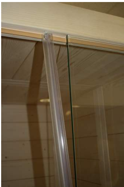
Fig. 20 : Positionnement du joint de la porte
